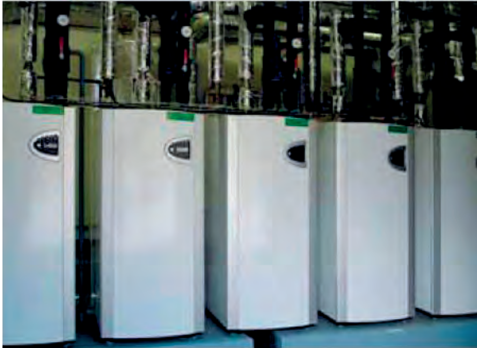
Tepelné čerpadlo využití geotermální energie v ZOO v Ústí nad Labem. Foto: Marek Bláha
