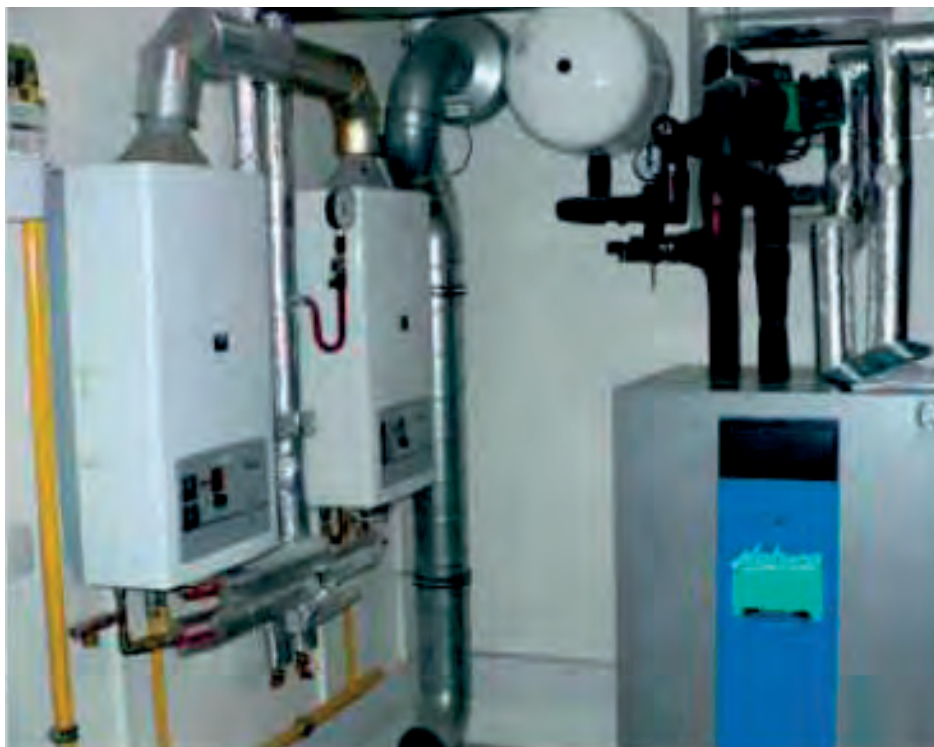
Tepelné čerpadlo pro vytápění bytového domu teplem z hlubinných vrtů. Foto: Karel Srdečný.EkoWATT
